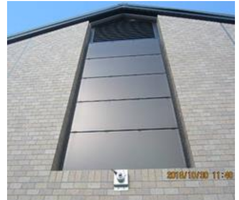
壁のへこみのある部分に設置
