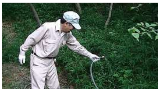
灌水成功！ ここまで下の散水栓からの長さ 約 30m、落差 5m 程度
