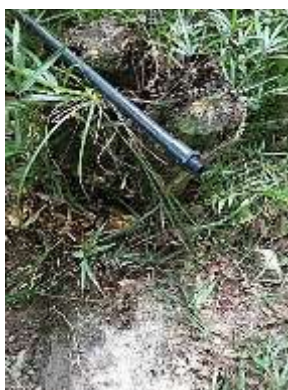
樹脂パイプとチューブのつなぎ目
